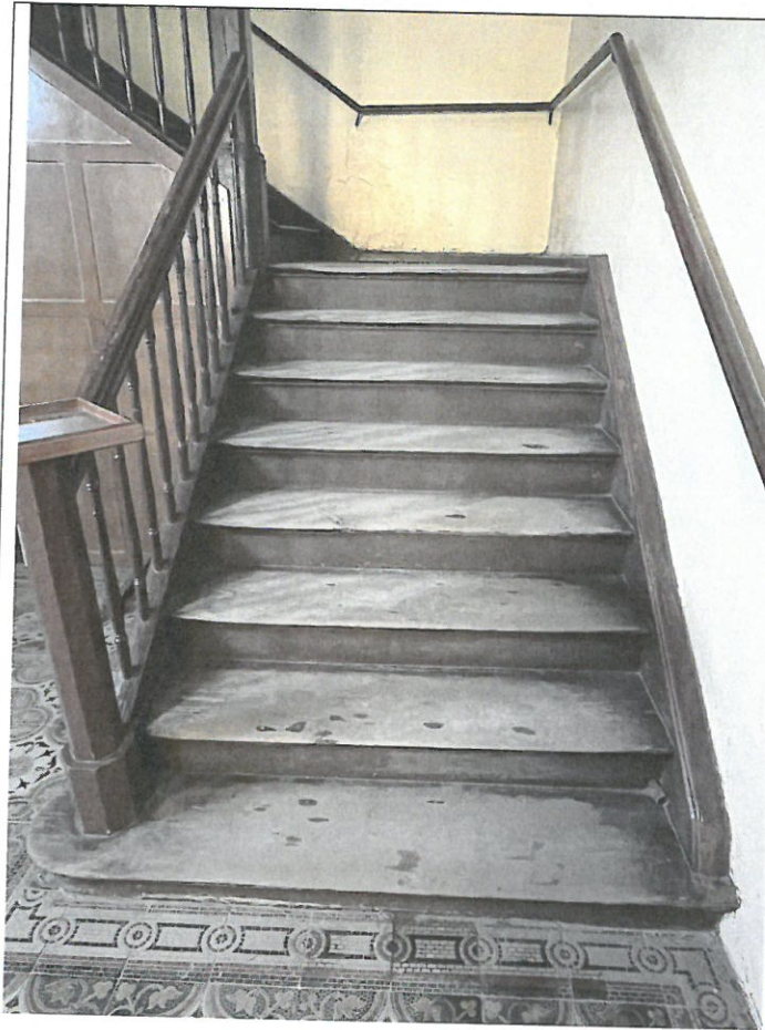
Fot. 18 Przedsiónek prawy – schody drewniane – widok na wytarte stopnice sosnowe
