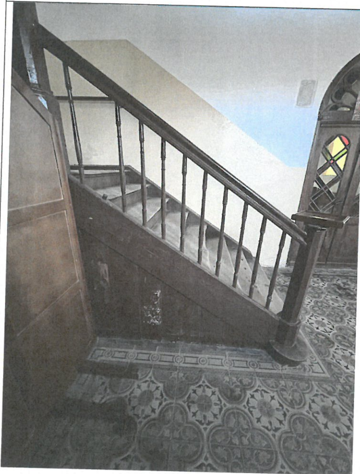
Fot. 17 Przedśionek prawy – schody drewniane z zabudowaną ścianą drewnianą oraz brakująca tralka balustrady
