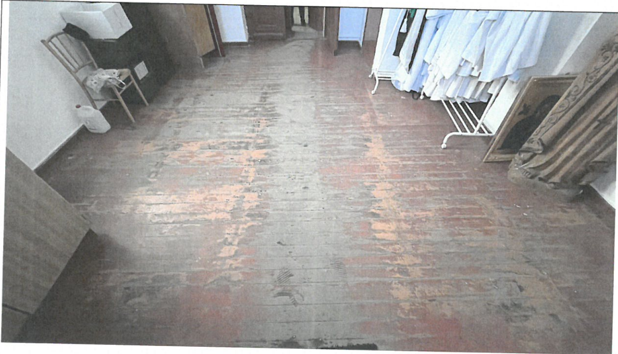
Fot. 21 Zakrystia – drewniana podłoga z desek sosnowych – zniszczenia powłoki malarskiej oraz wytarcia desek.
