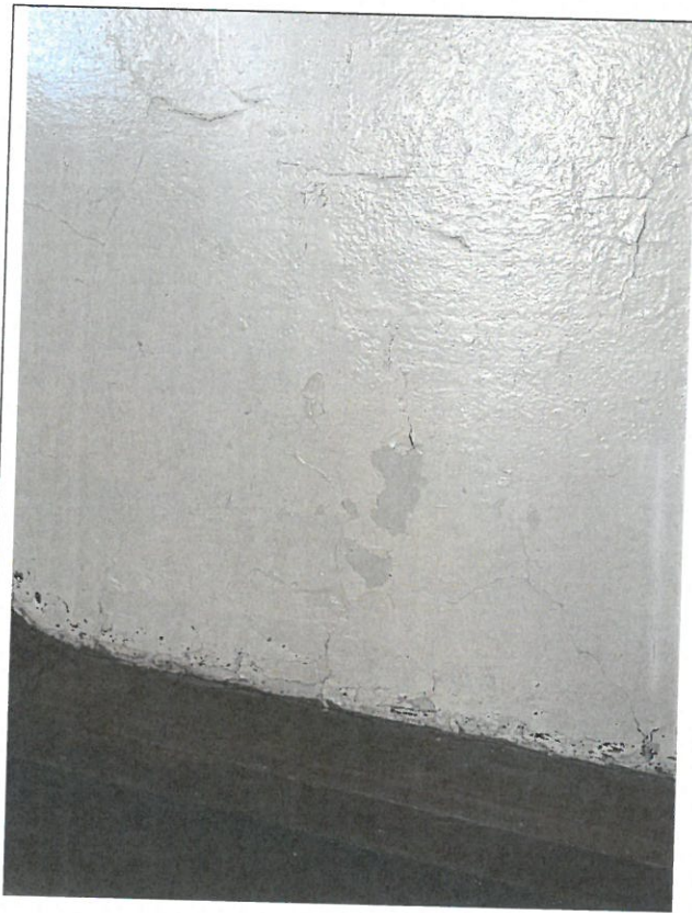
Fot. 8 Przedśionek prawy – zluszczenia, odspojenia warstw malarskich lamperii i spękania tynków w obrębie schodów
