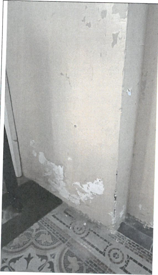
Fot. 6 Przedśionek prawy – odpadające, zawilgocone tynki, odspojenia warstw malarskich
