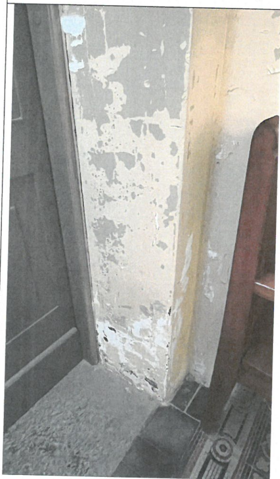
Fot. 5 Przedsionek prawy – skorodowane, zawilgocone tynki, odspojenia warstw malarskich
