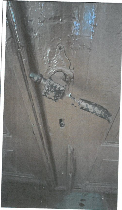
Fot. 16 Zakrystia – drzwi wewnętrzne dwuskrzydłowe pomiędzy salkami – klamka z zamkiem, ubytki w listwowaniu
