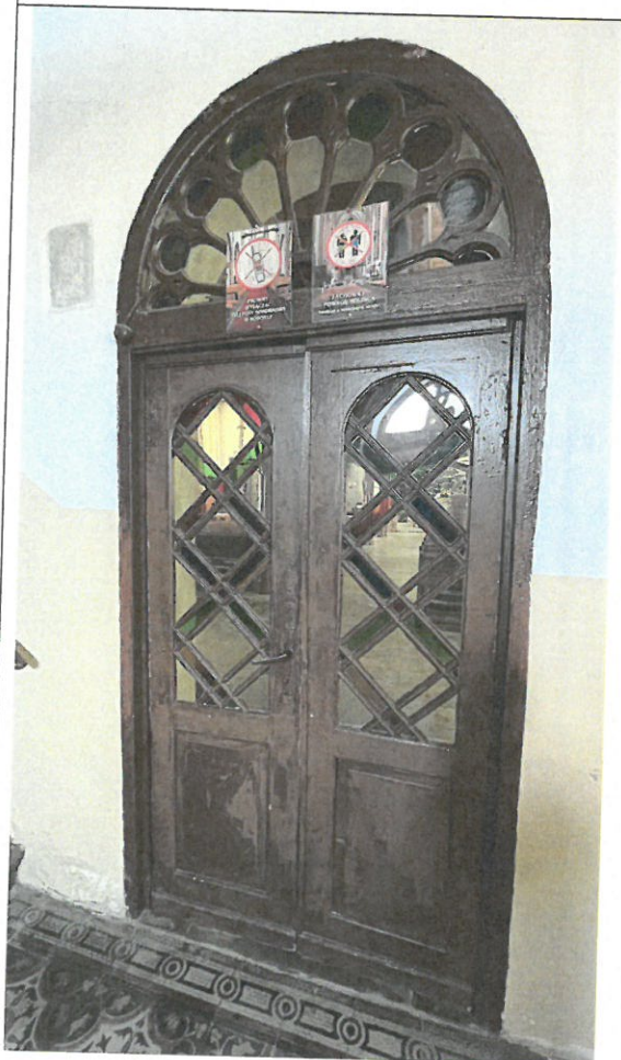
Fot. 9 Przedśionek prawy – drzwi wewnętrzne dwuskrzydłowe – zniszczenia powłok malarskich, spękania szklenia
