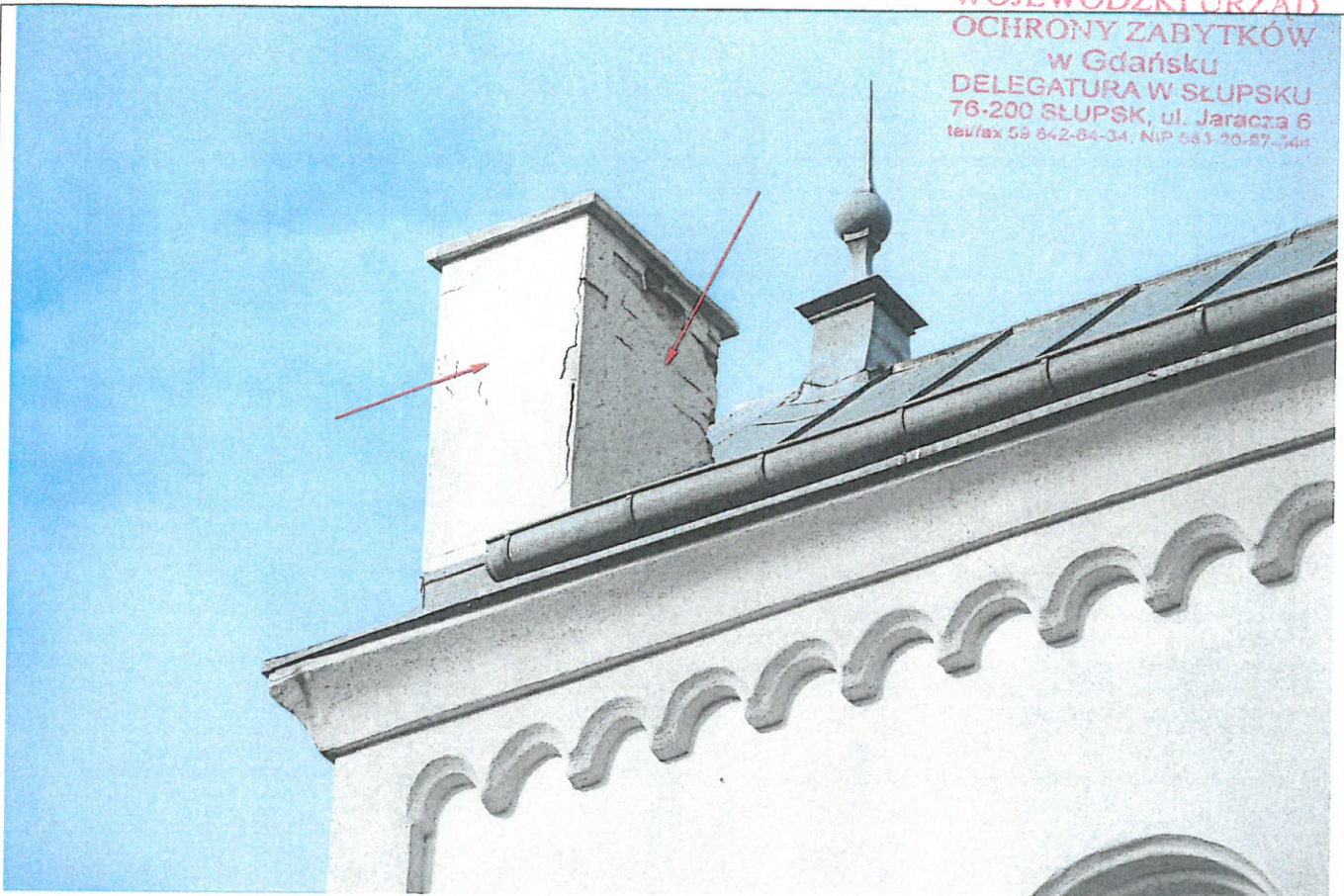
Fot. 12 - Odpadający, luźny tynk na kominie
