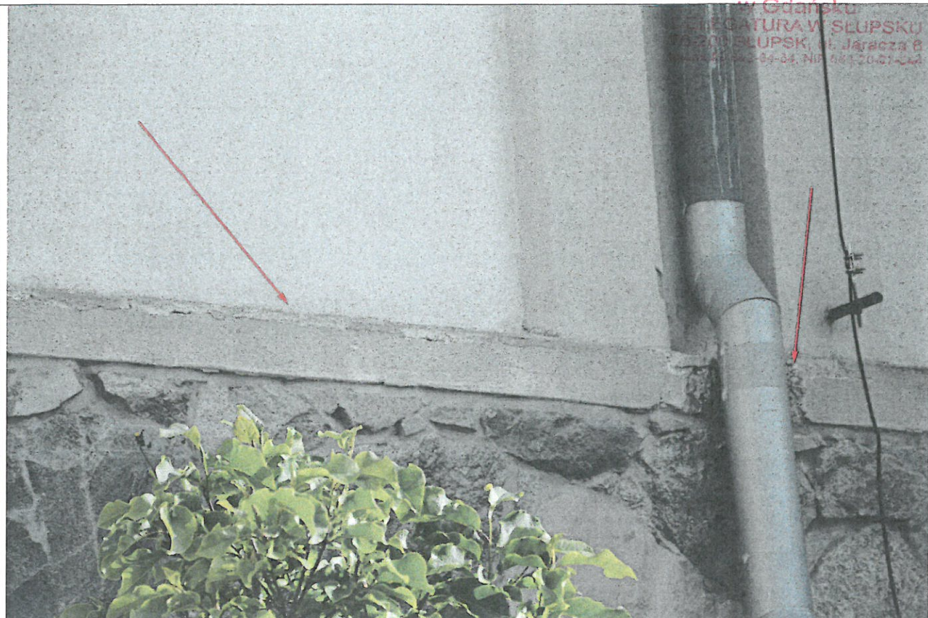
Fot. 6 – Zniszczony tynk rolki ceglanej cokolowej
