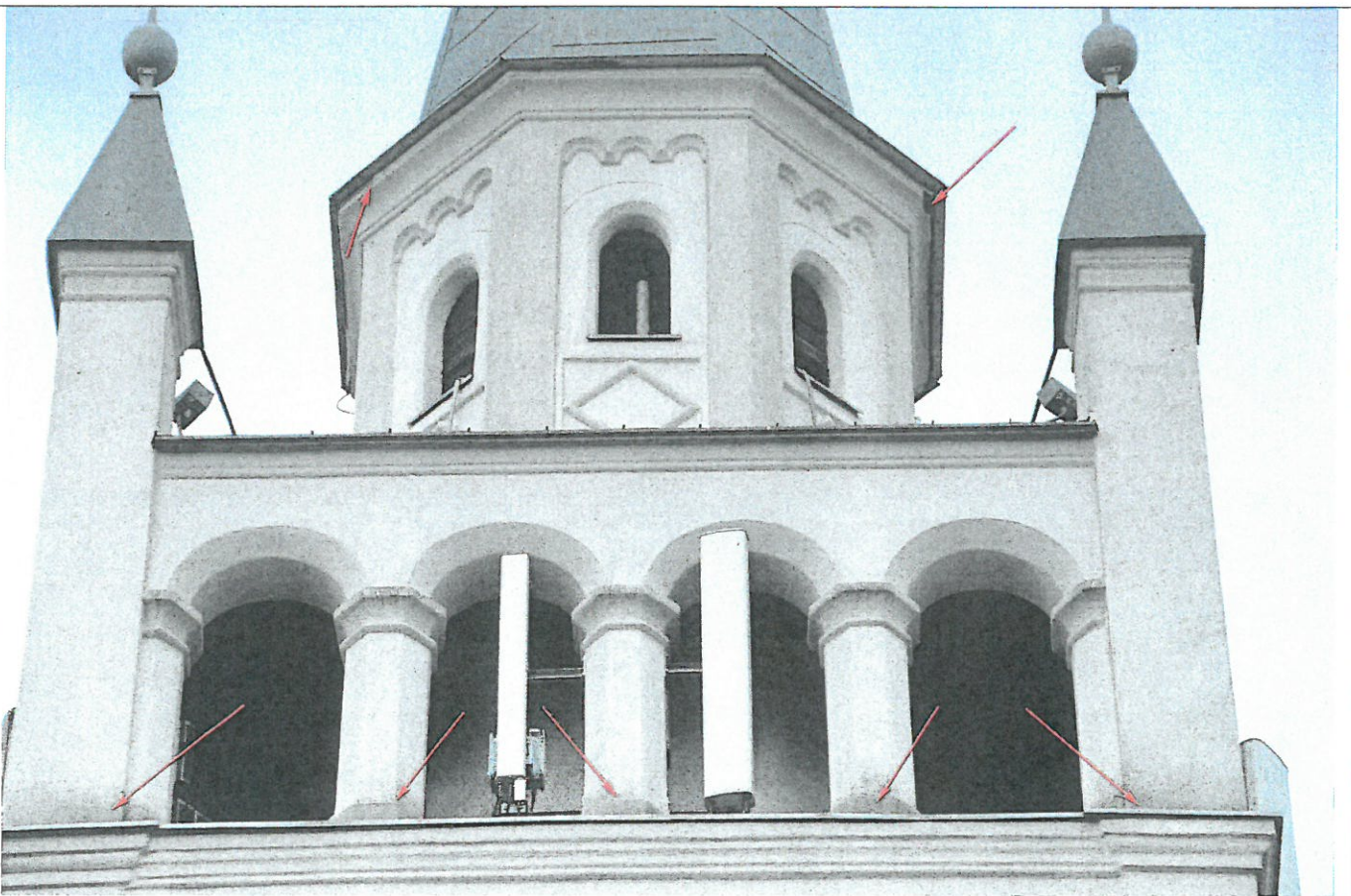
Fot. 2 - Zabrudzenia kolumn i słupów oraz uszkodzenia gzymsów wieży
