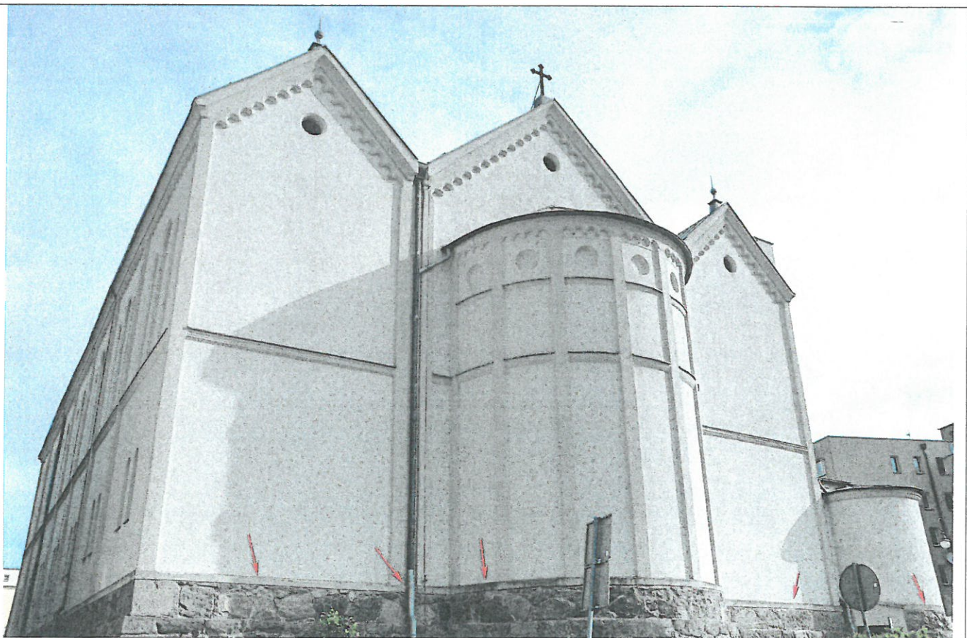
Fot. 9 – Zniszczenia tynku na rolce ceglanej cokolowej tynkowanej
