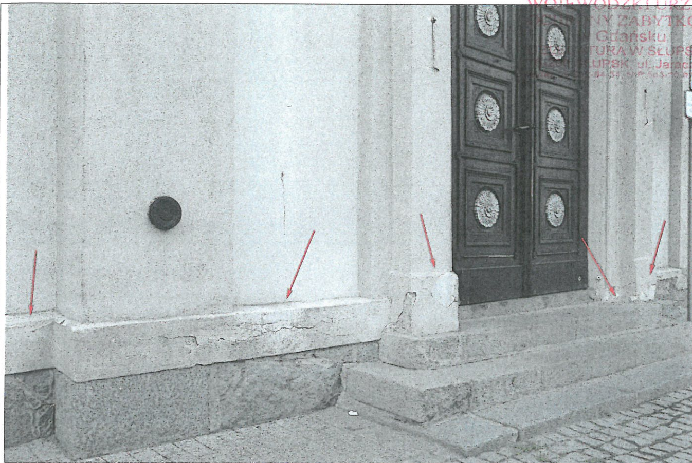
Fot. 4 – Luźne, odspojone, plustrujące tynki w obrębie rolki cokolowej
